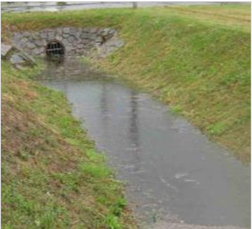
Offene Ableitung von anfallendem Regenwasser Quelle: FG Siedlungswasserwirtschaft TU Kaiserslautern
